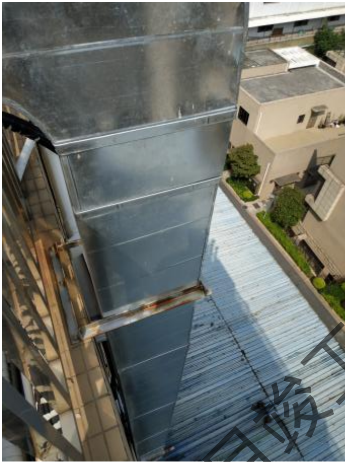
废气处理设施 废气收集管道
