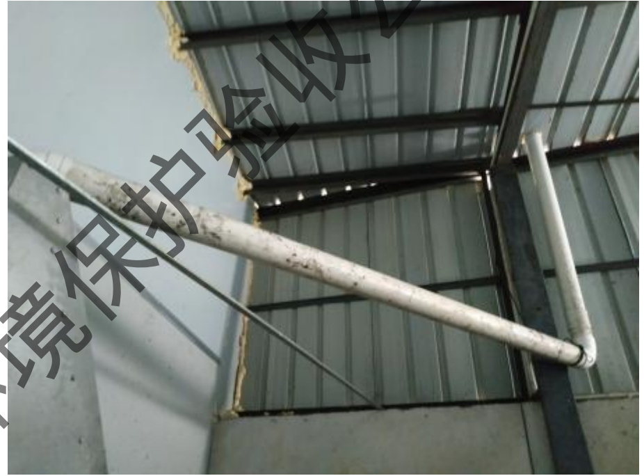
废水处理设施收集管道
