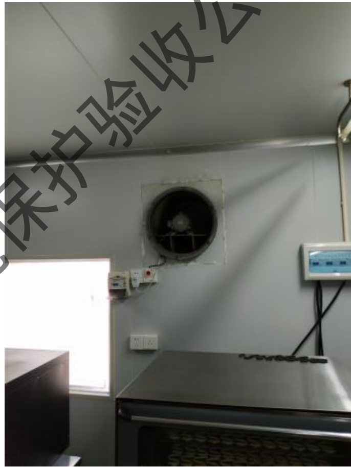
废气处理设施 废气收集口
