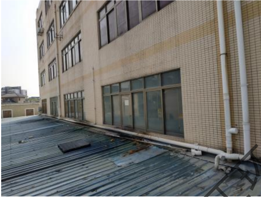
废水处理设施收集管道
