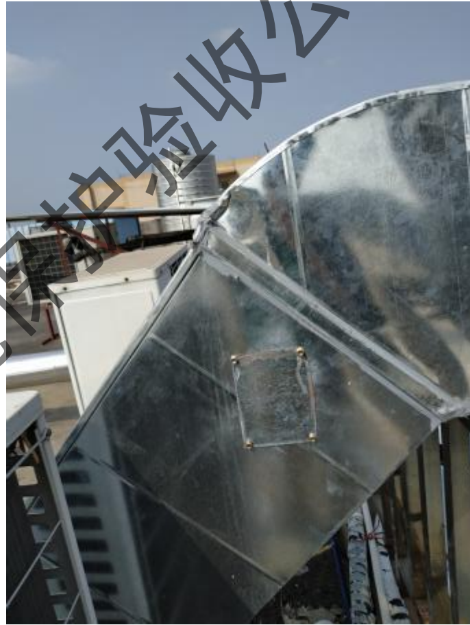
废气处理设施 采样口
